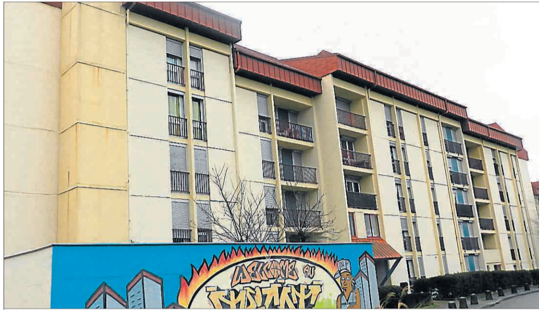
Au Tricot, les menuiseries des 210 logements doivent être remplacées.
